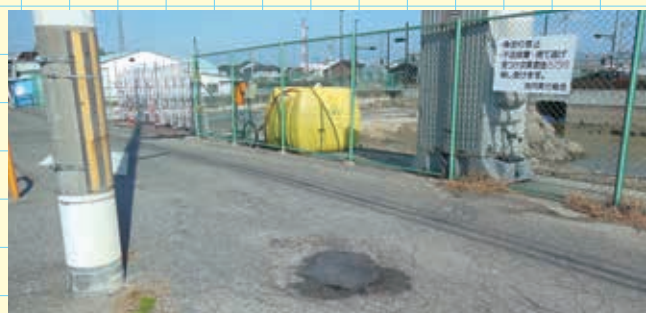
平成28.1月 天美東2丁目136 池内農事実行組合作業所前の道路陥没を修正
