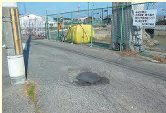
平成28年1月 天美東2丁目136 池内農事実行組作業所前の道路陥没を修正させていただきました。
