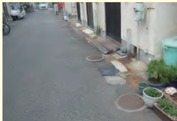
平成28年2月 天美南2-117-22付近、安全確保のため、道路陥没を修正させていただきました。
