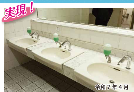
役所内1階・2階の男女トイレ 市民の皆様から寄せられたご要望を受け、自動手洗い器を設置いたしました。
